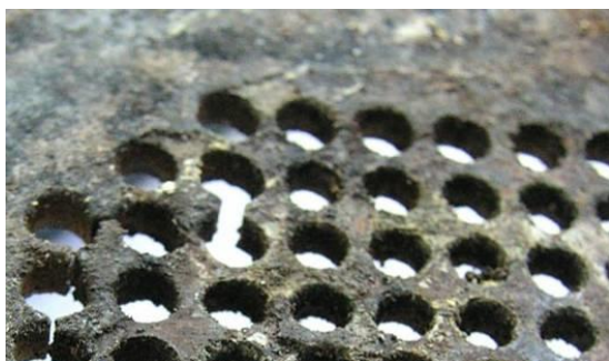
Fig. 18 : matériau de la grille fissuré
